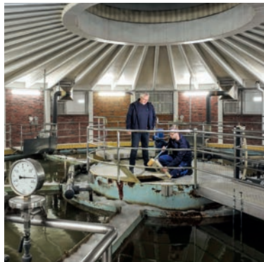
Wasserwerk in Marienhäfe: Mit innovativer Technik zu noch besserem Trinkwasser
